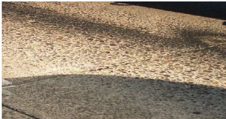
รูปที่ 3.24 ลักษณะความเสียหายของผิวทางคอนกรีต ประเภทผิวทางลื่น
