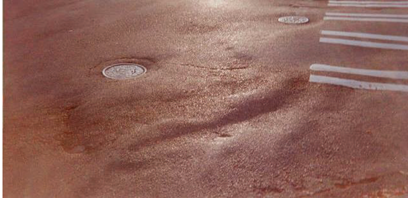
รูปที่ 3.10 ลักษณะความเสียหายของผิวทางลาดยาง ประเภทลอนคลื่นและรอยย่น
