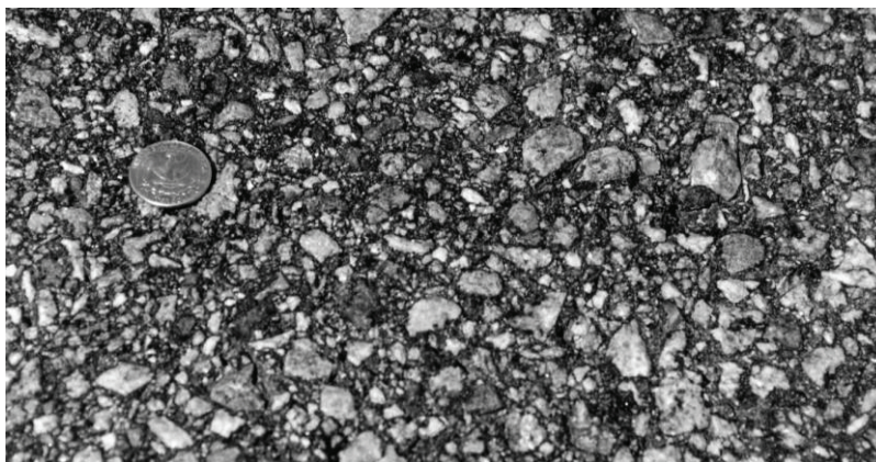
รูปที่ 3.15 ลักษณะความเสียหายของผิวทางลาดยาง ประเภทผิวทางถูกขัดสี
