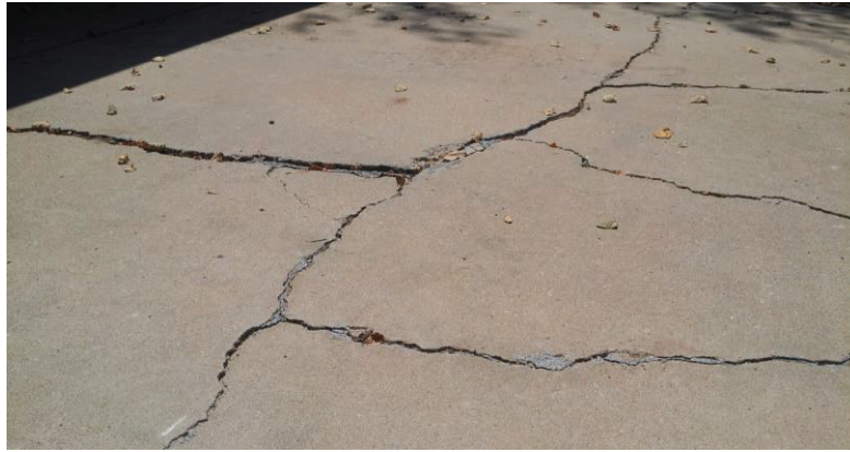
รูปที่ 3.27 ลักษณะความเสียหายของผิวทางคอนกรีต ประเภทรอยแตกจากการหดตัว
