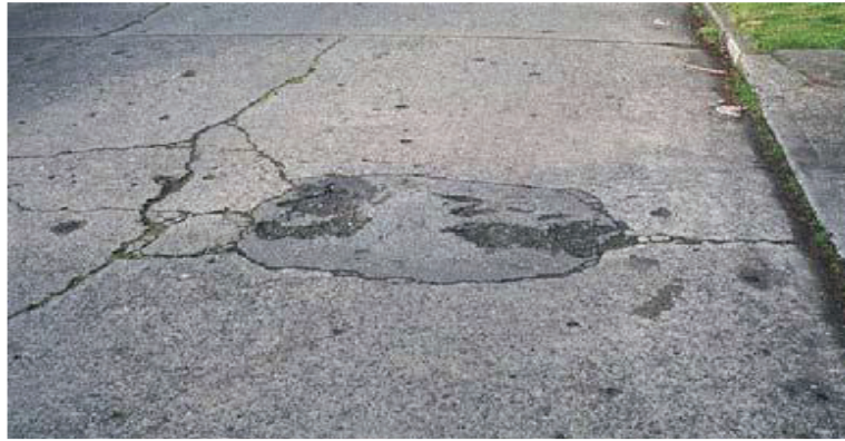
รูปที่ 3.23 ลักษณะความเสียหายของผิวทางคอนกรีต ประเภทรอยปะซ่อม
