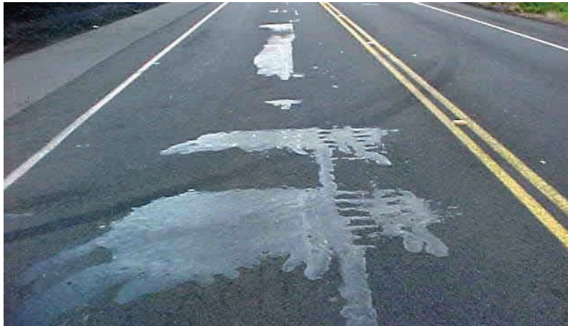
รูปที่ 3.14 ลักษณะความเสียหายของถนนผิวทางลาดยางประเภทผิวทางเยิ้ม
