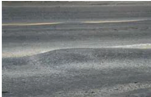
รูปที่ 1.4 ร่องล้อ (Rutting)
