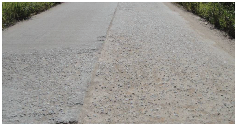
รูปที่ 3.26 ลักษณะความเสียหายของผิวทางคอนกรีต ประเภทหลุดร่อน
