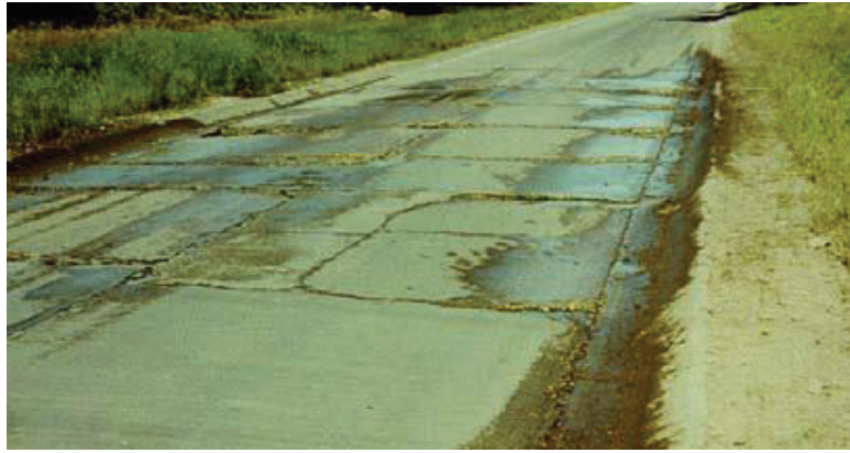
รูปที่ 3.25 ลักษณะความเสียหายของถนนผิวทางคอนกรีต ประเภทการอัดทะลักของน้ำใต้แผ่นดิน
