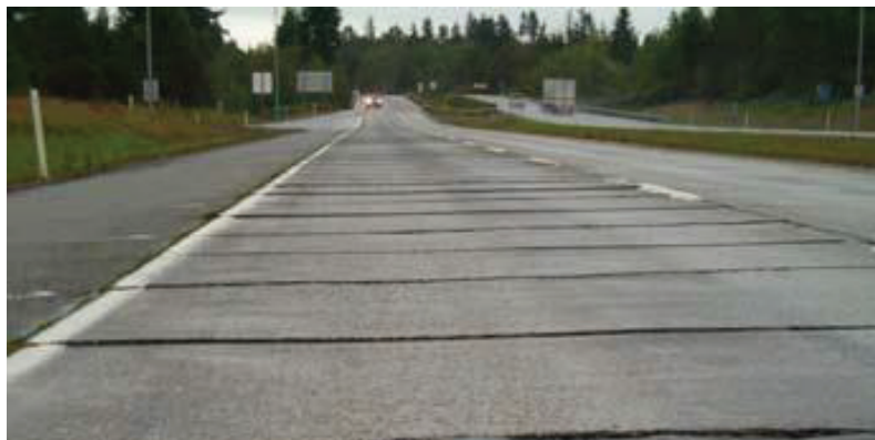
รูปที่ 3.20 ลักษณะความเสียหายของผิวทางคอนกรีต ประเภททรุดตัวต่างระดับ
