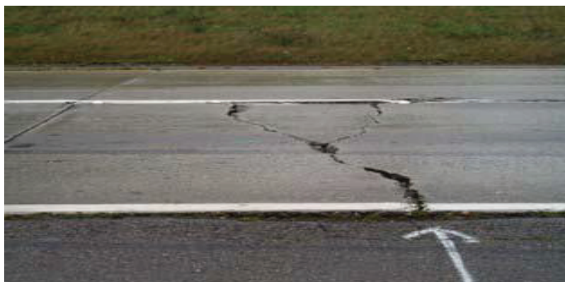
รูปที่ 3.18 ลักษณะความเสียหายของผิวทางคอนกรีต ประเภทแผ่นพื้นแตกและแยกตัว
